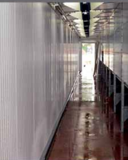
Повністю обшита сторона вентиляторів
